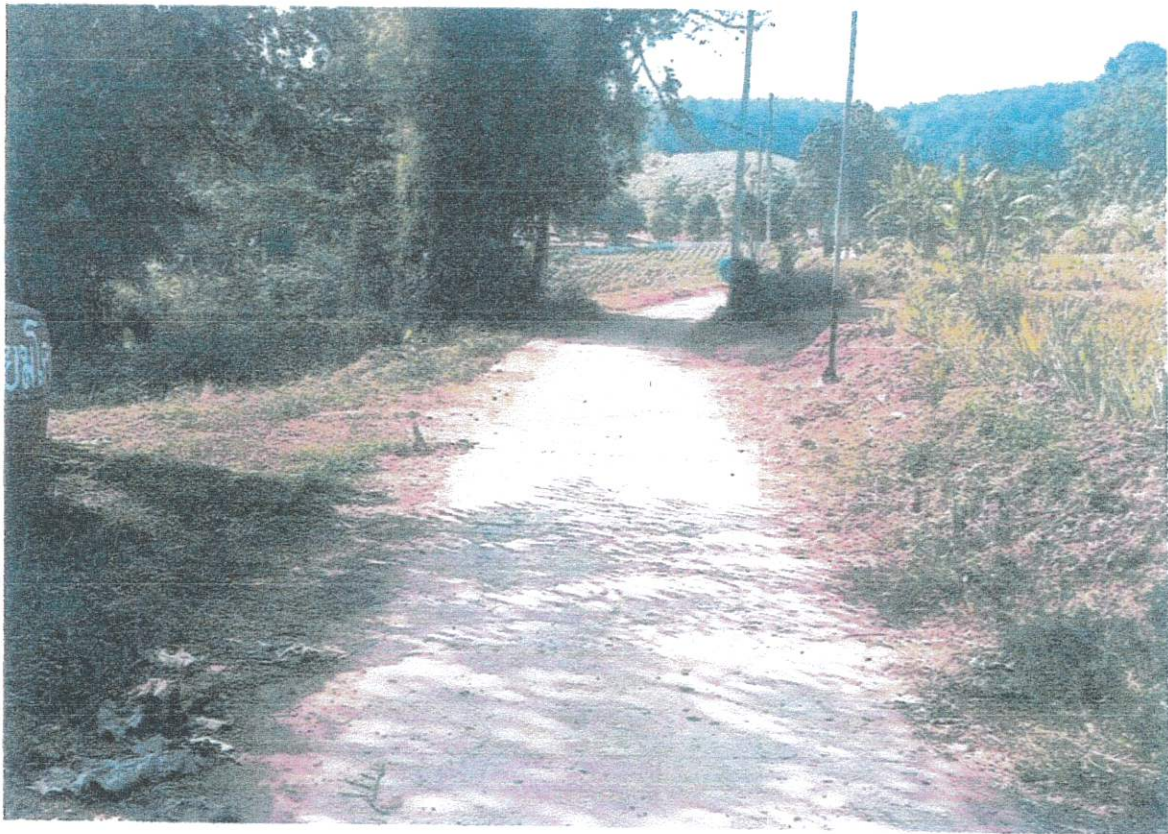
ภาพถ่ายดำเนินการโครงการปรับปรุงผิวถนนแอสฟัลต์คอนกรีต (สายหลัง อบต.น้ำหวาน) สถานที่ บ้านไร่ม่วง หมู่ที่ 1 ตำบลน้ำหวาน อำเภอเมืองเลย จังหวัดเลย
